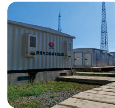
运城电厂调峰项目
