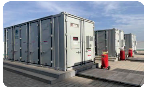
陕西首个高功率锂电池+超级电容混合火储联调项目
