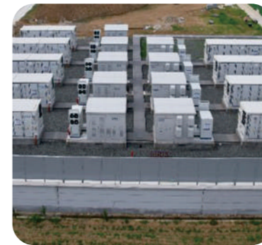
五河绿色能源基地光储项目
